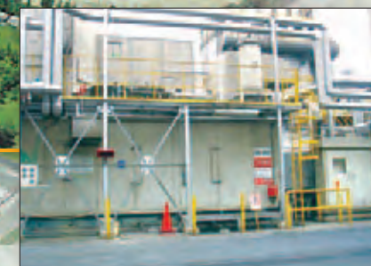
白河工場のコージェネレーションシステム
