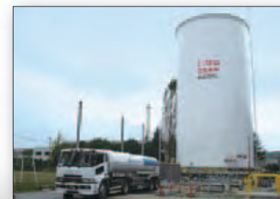
新たに建設した、日本最大級の規模のLNGサテライト基地
